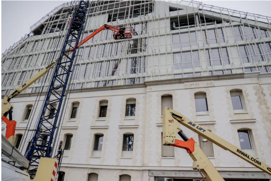
De l'ancien mess des officiers de la caserne militaire où doit s'installer l'école de commerce, seuls les quatre murs ont été conservés.
